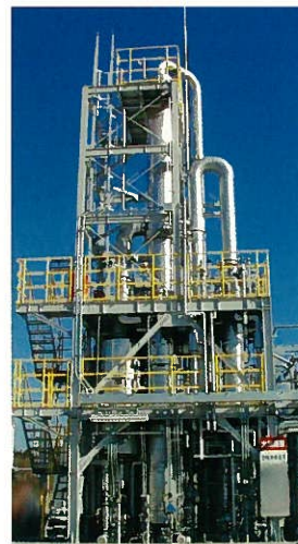
「溶剤回収装置」
