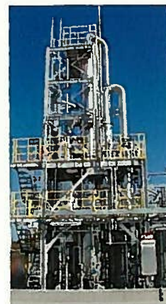
〔溶剤回収装置〕
