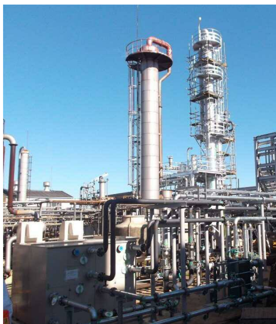
図1 ヒートポンプ型メタノール蒸留設備(右奥が新設)
