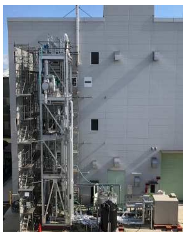
図 4. ヒートポンプ式アンモニア回収装置 (テスト装置 当社尼崎工場内に設置)
