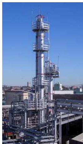
図 4. 省エネ型ヒートポンプ式蒸留装置 (名糖産業 八王子工場にて施工)
