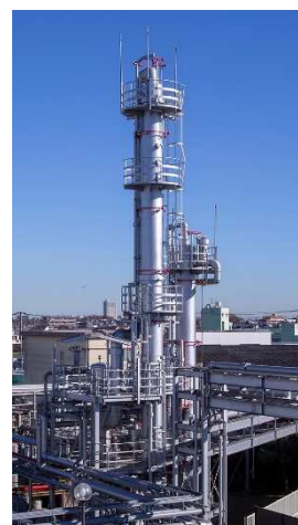
図 4.省エネ型ヒートポンプ式蒸留装置 (名糖産業 八王子工場にて施工)
