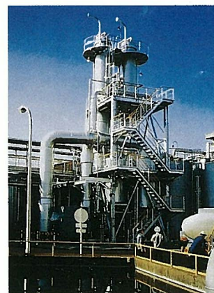
「蒸発濃縮装置（自己蒸気圧縮型）」
